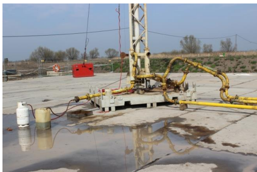
Rys. 4. Podstawa komin zrzutowego w przykładowej
