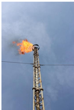
Rys. 3 Komin zrzutowy w analizowanej instalacji.
