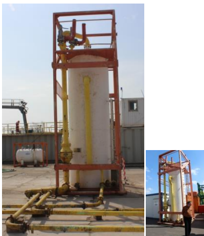
Rys. 1. Odstojnik komina zrzutowego w analizowanej instalacji.
