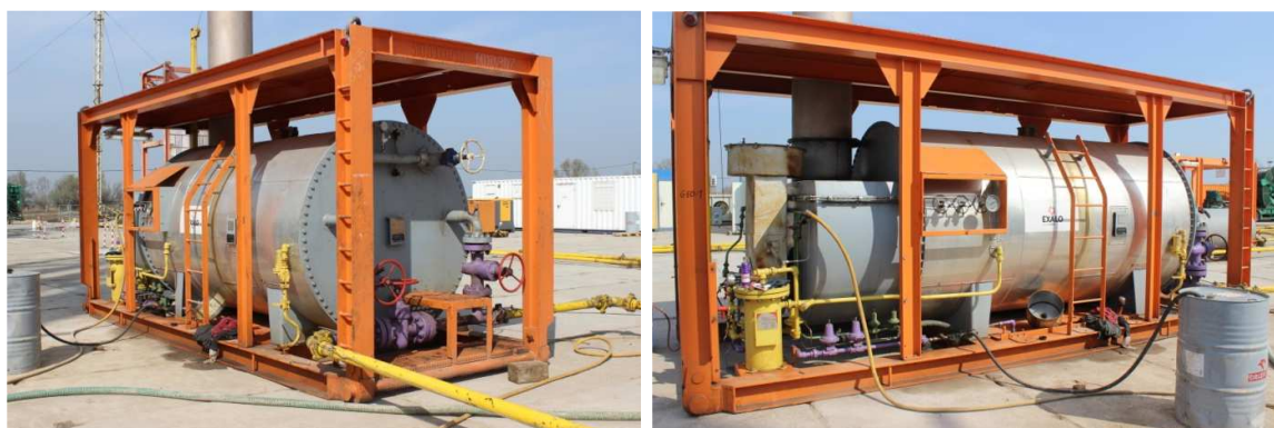
Rys.8 a; b. Podgrzewacz w istniejącej instalacji
