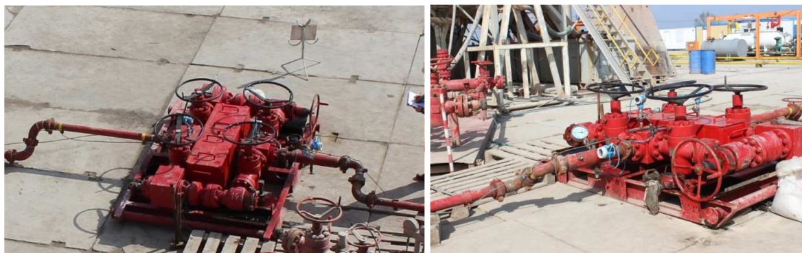
Rys.7 a; b. Manifold zwężkowy w istniejącej instalacji.
