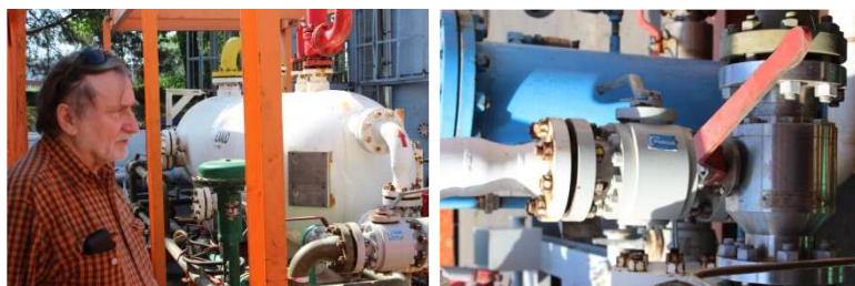
Rys. 30. Dwa rodzaje zaworów kulowych na jednej instalacji.
