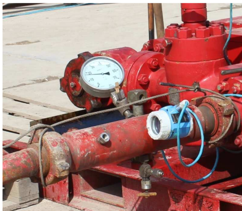
Rys.6. Odcinek pomiarowy w istniejącej instalacji.
