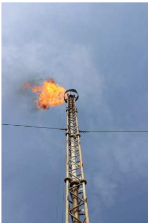
Rys. 14. Odstoju komin zrzutowego w analizowanej instalacji.
