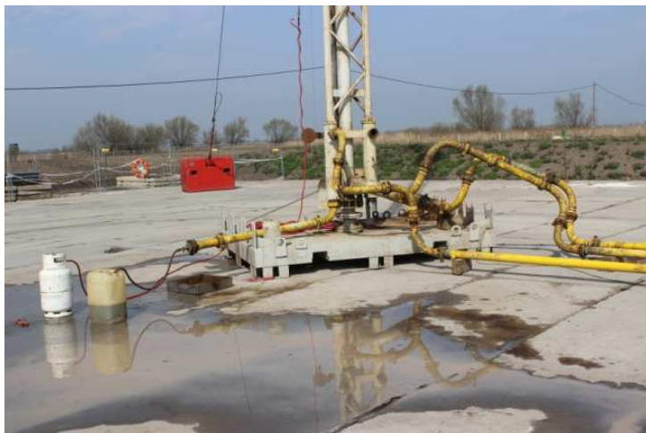
Rys. 15. Podstawa komina zrzutowego w przykładowej instalacji.
