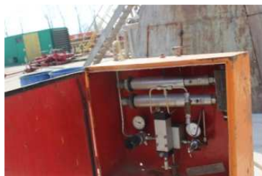
Rys. 26. Panel sterujący ESD w opisywanej instalacji.
