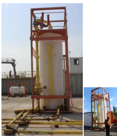
Rys. 1. Odstojnik komina zrzutowego w analizowanej instalacji.
