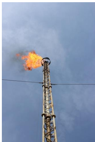
Rys. 3 Komin zrzutowy w analizowanej instalacji.
