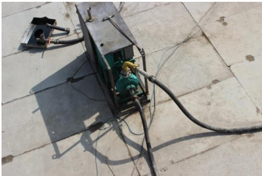
Rys.23. Pompa transferowa główna.
