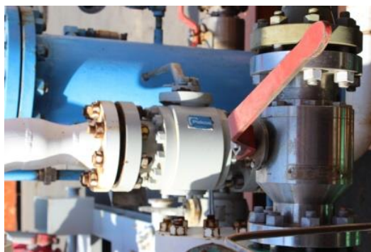
Rys. 34. Dwa rodzaje zaworów kulowych na jednej instalacji.
