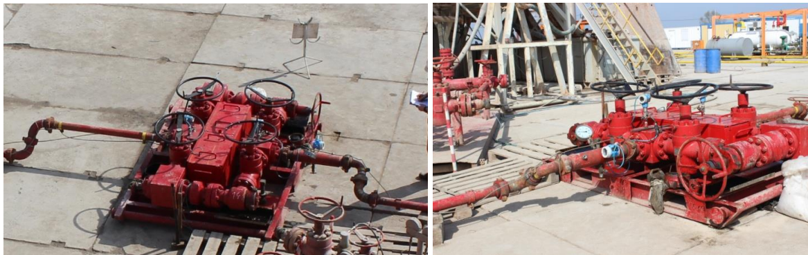
Rys.7 a; b. Manifold zwężkowy w istniejącej instalacji.
