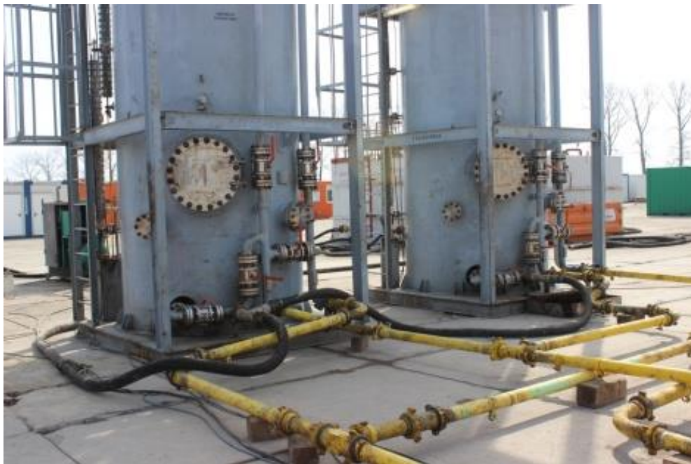
Rys. 21. Separator pionowy – zbiornik pomiarowy w analizowanej instalacji roboczej.
