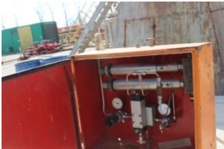
Rys. 30. Panel sterujący ESD w opisywanej instalacji.
