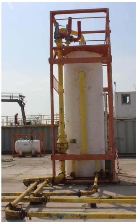
Rys. 16. Odstojnik komina zrzutowego w analizowanej instalacji
