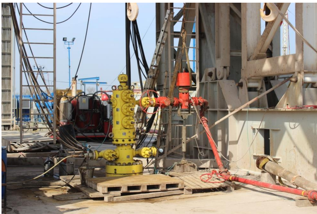
Rys.2 Widok głowicy eksploatacyjnej produkcji ZUN Naftomet typu „Solid Block” z dedykowaną zasuwą bezpieczeństwa 21/16” x 70 MPa Cameron
